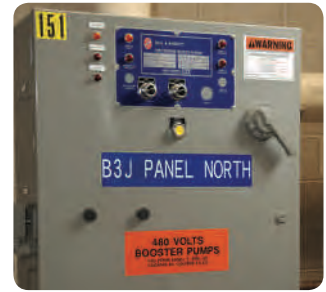
Étiquettes pour panneaux de contrôle et panneaux électriques
